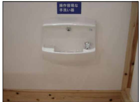
写真8 手洗い 右の栓を押せば,一定時間水が流れるもの。センサーで水をコントロールしているものも多い。
